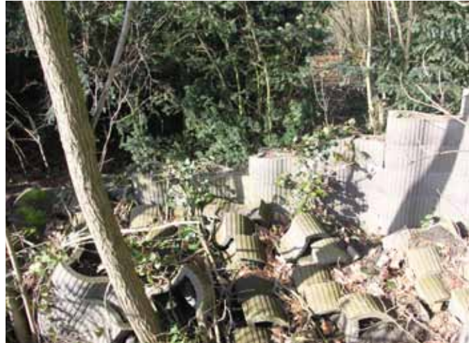
De ingestorte muur van betonbakken.
